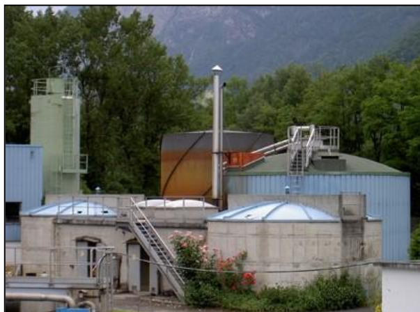
Méthaniseur de station d'épuration
